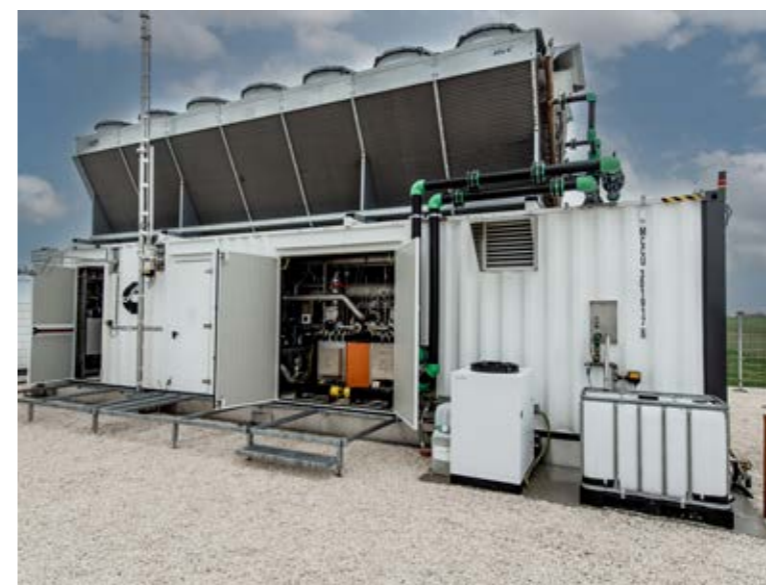
2 MW Wasser-Elektrolyse in Rubensdorf
