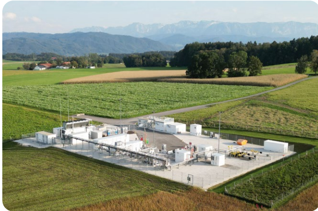
Demonstrationsanlage Wasserstoffspeicher, RAG Austria AG, Rubensdorf
